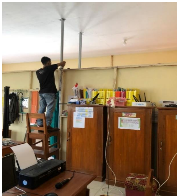
Gambar 1. Pengambilan Sumber Listrik
